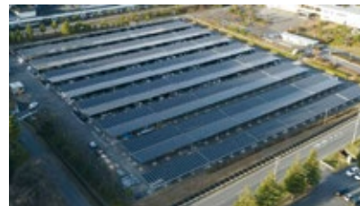
太陽光発電設備
