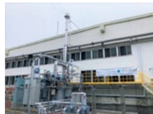
水素ボイラー
